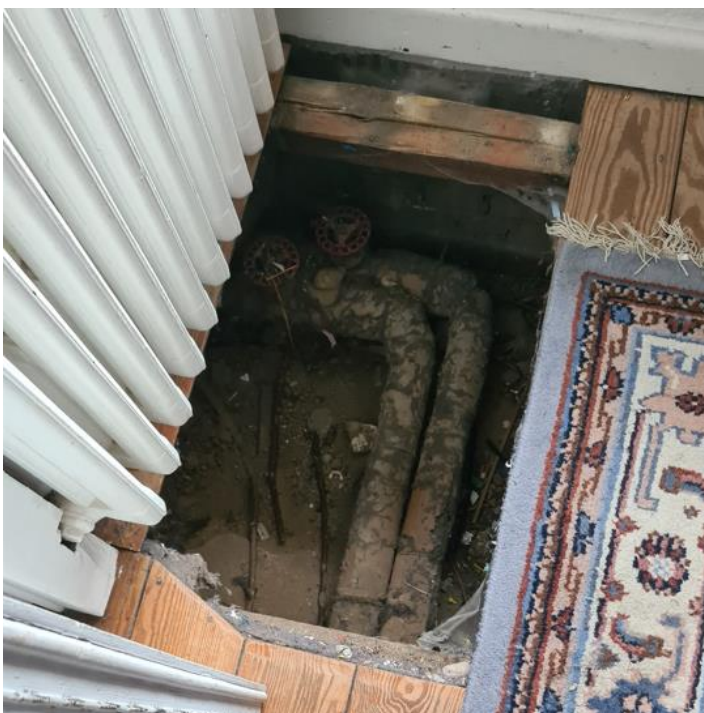
Abbildung 36: Loch im Fußboden – Grundschule
