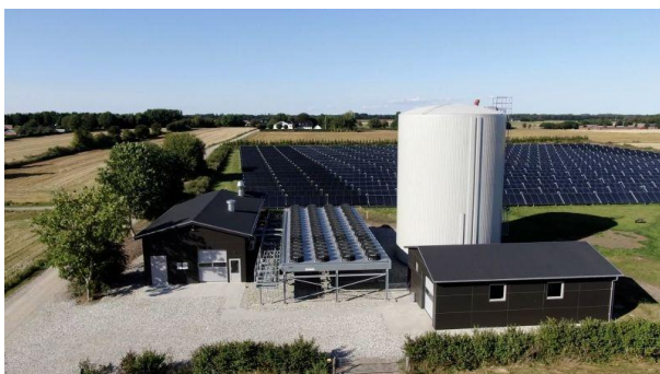
Abbildung 44: Heizzentrale eines wärmepumpenbasierten Wärmenetzes (Aalborg CSP, 2022)
